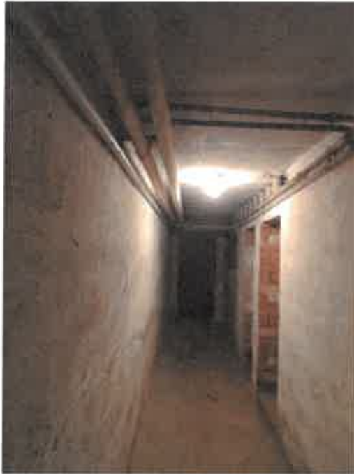
Der Keller dient unter anderem als Heizungsraum. Wände und Decken sind eben und verputzt.
